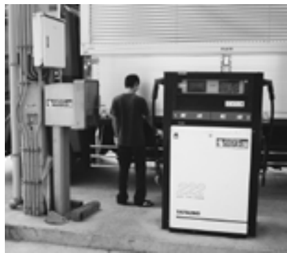
組合給油施設
